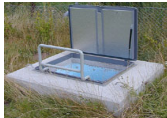
Fig 7. Lucka till fjärrvärme
