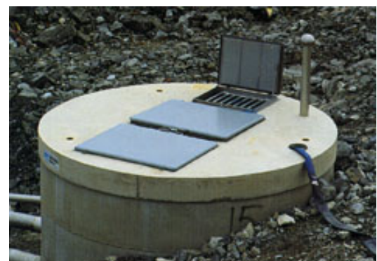
Fig 8. Pumpstation med 3 Abat-luckor
